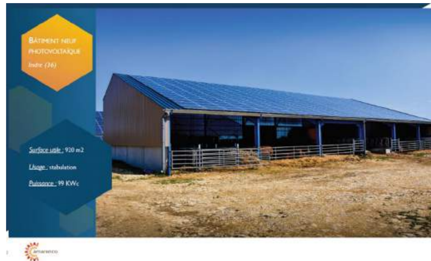
Figure 14 : Bâtiment neuf photovoltaïque dans l'Indre (36) (Source : AMARENCOI)
