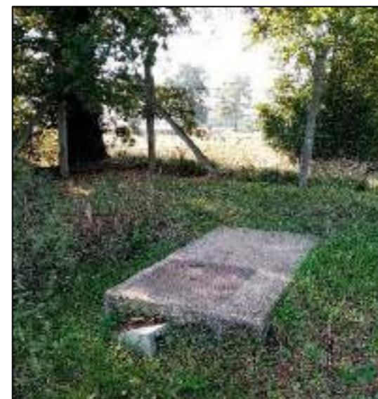
Figure 46 : Ouvrage AEP potentiel dans l’emprise du site d’étude (Crédit photo : NCA Environnement, octobre 2021)
