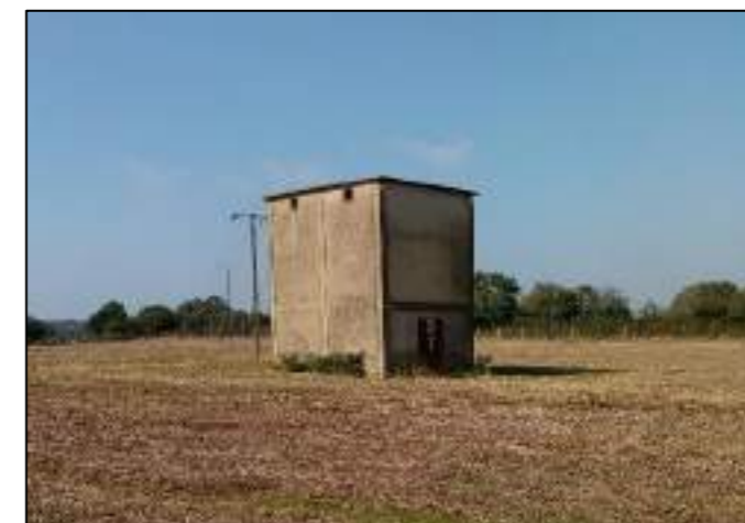
Figure 47 : Ligne HTA et poste électrique dans l’emprise du site d’étude (Crédit photo : NCA Environnement, octobre 2021)
